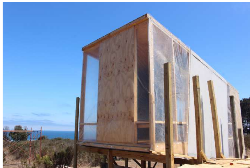
Fig.306 Espaciocubierto de polietileno. Elaboración propia.
