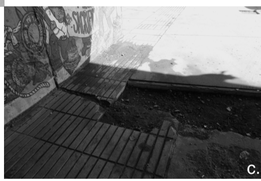
Un hoyo que corta el bandejón transitable, genera una discontinuidad del plano, y obstaculiza el paso y pone en riesgo al transeúnte
