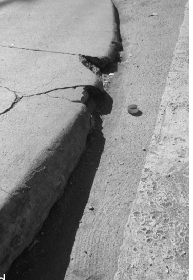
El paso peatonal se encuentra con la vereda sin rampa, rebaje construido, generando así un desnivel de 15 cm aproximadamente.
