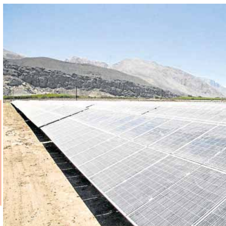
◀ Los paneles solares instalados en la Agrícola Don Alfonso, en la Tercera Región. FOTO: SUBSOLE
