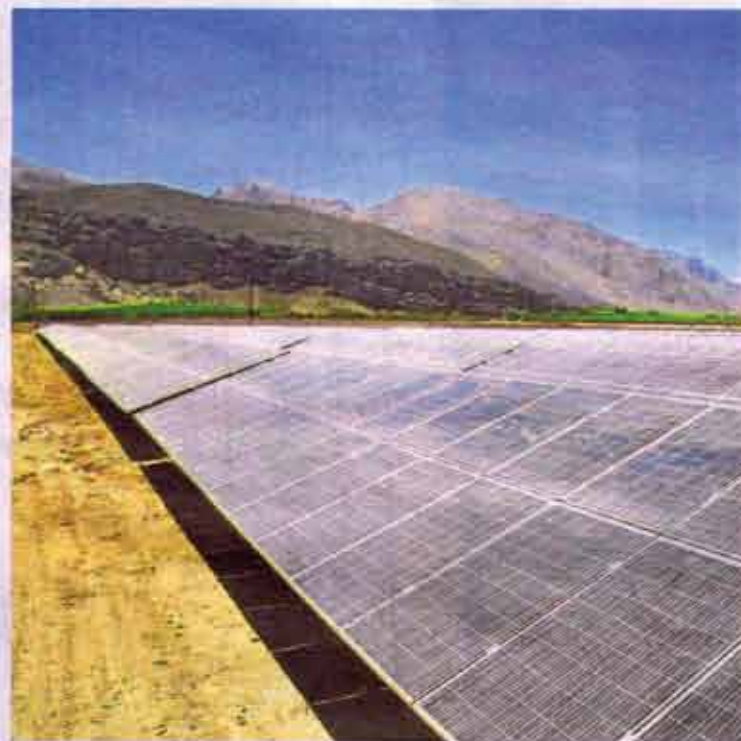
◀ Los paneles solares instalados en la Agrícola Don Alfonso, en la Tercera Región. FOTO: SUBSOLE
