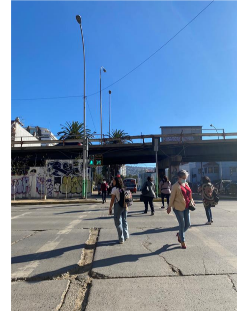
RECORRIDO 1. El cruce esta deteriorado, reduciendo la movilidad plena de transeúntes. El semáforo no cumple con la norma pues este no posee sonido de advertencia.
