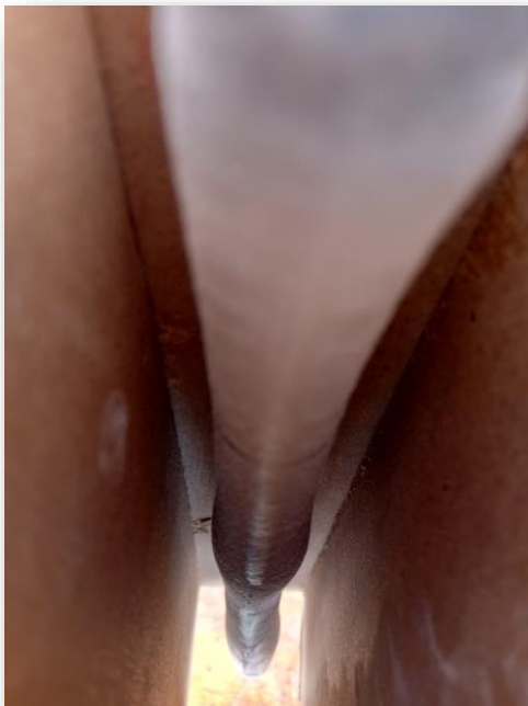
Vista interior de la viga con la mezcla de yeso aún fresca.
