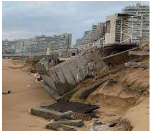
Dstrucción de la contención de las piscinas del conjunto habitacional por marejadas y erosión. Fuente: https://laderasur.com/articulo/los-molles-algarrobo-y-las-desastrosas-consecuencias-de-construir-sobre-humedales-y-degradar-la-zona-costera/
